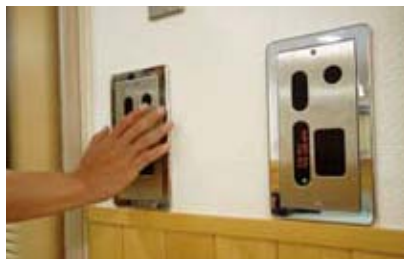
トイレ入口のタッチセンサー
