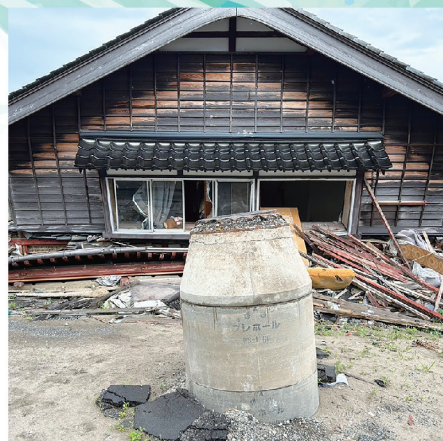
地震によって飛び出たマンホール
